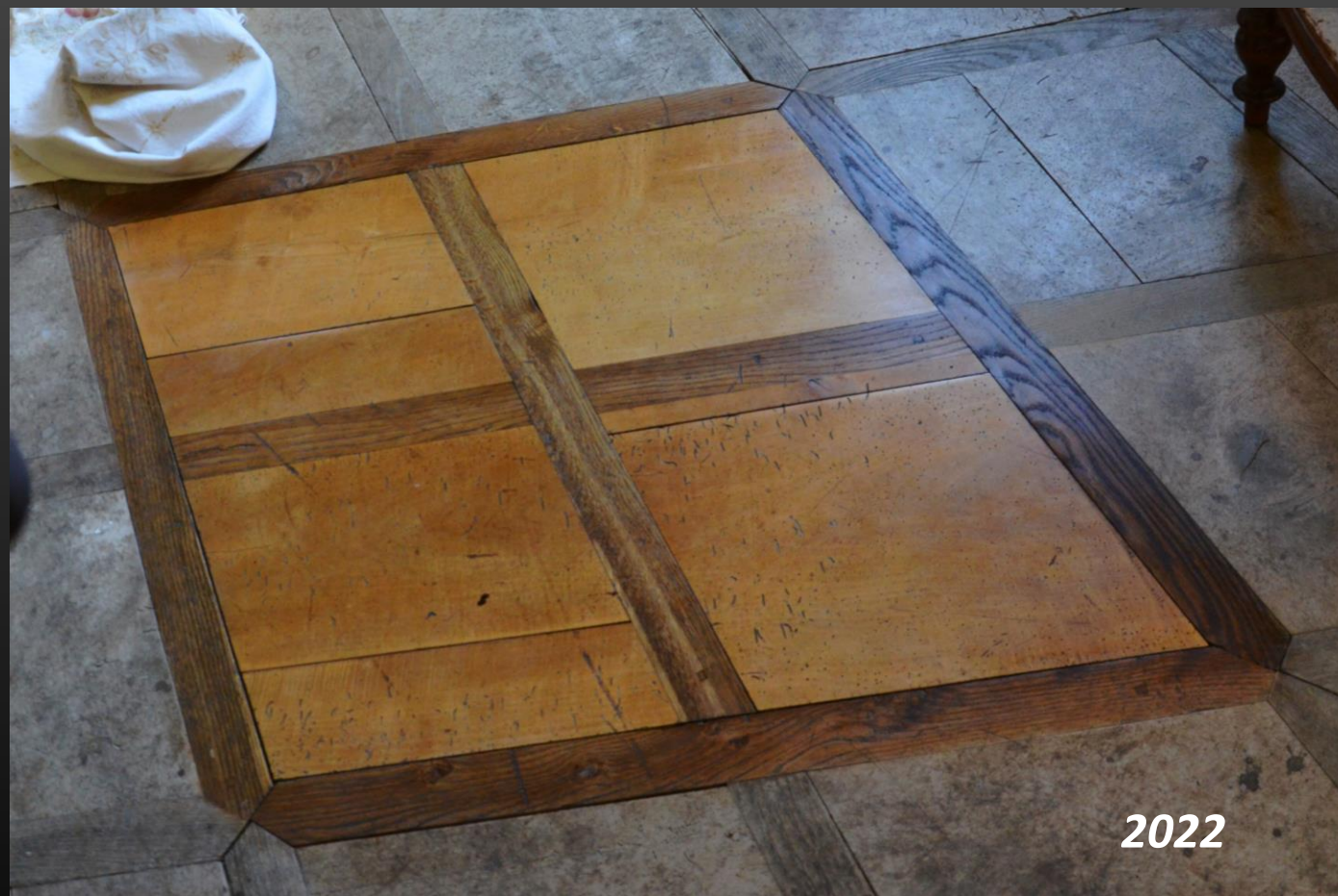
Vzorek destruované a zrestaurované podlahy
